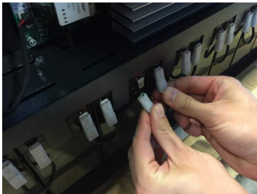
Рисунок 10. Электрическое соединение батарей с помощью перемычки
